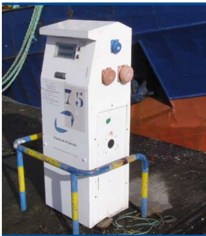
Unidad de conexión a la red eléctrica portuaria
